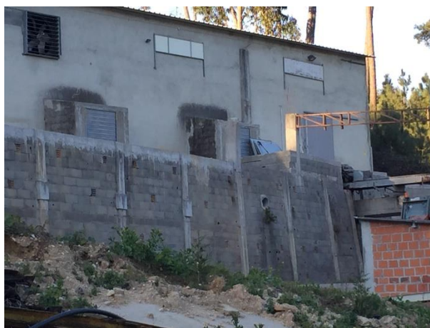
Figura 2.4 – Descarga de drenagem de águas pluviais do pavilhão 3 para o terreno natural onde se infiltra
